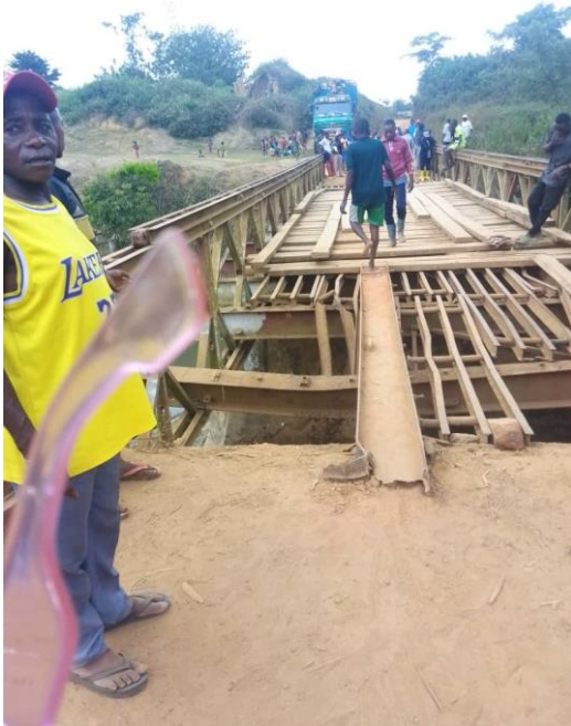
Photo 3: Pont Kihembwe délabré sur la RN 32
